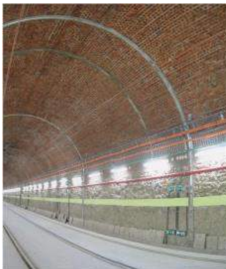
Figura 2.9 - Exemplo de anéis de fibra ótica em túnel (Túnel do Rossio, Lisboa) (extraído de Google: Sistema de Monitorização Estrutural para Túneis -SysTunnel)
