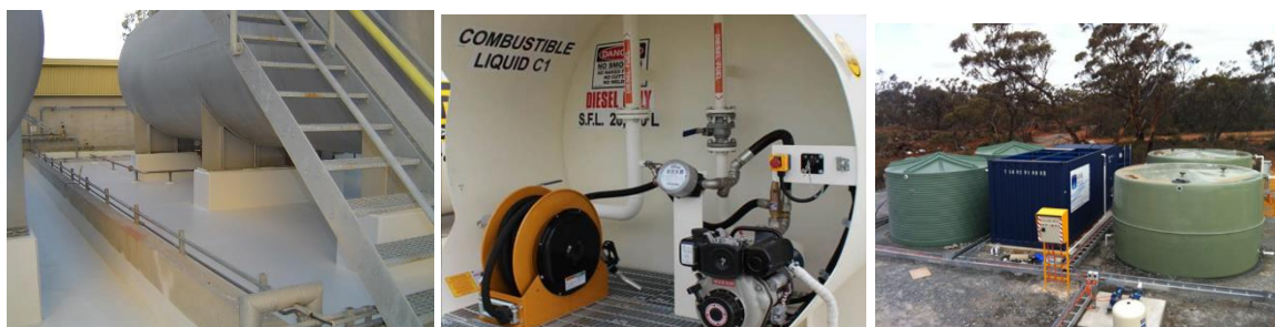
Figura 13- Ejemplos de las unidades de suministro de gasóleo y de la EDAR.
