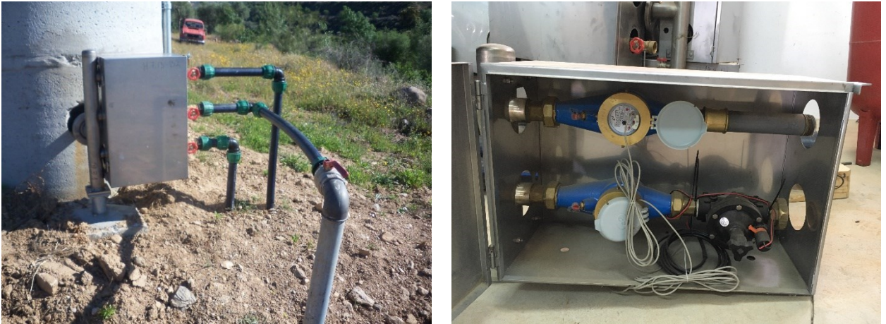
Figura 9.1 - Contadores individuais instalados em perímetros de rega na região norte
