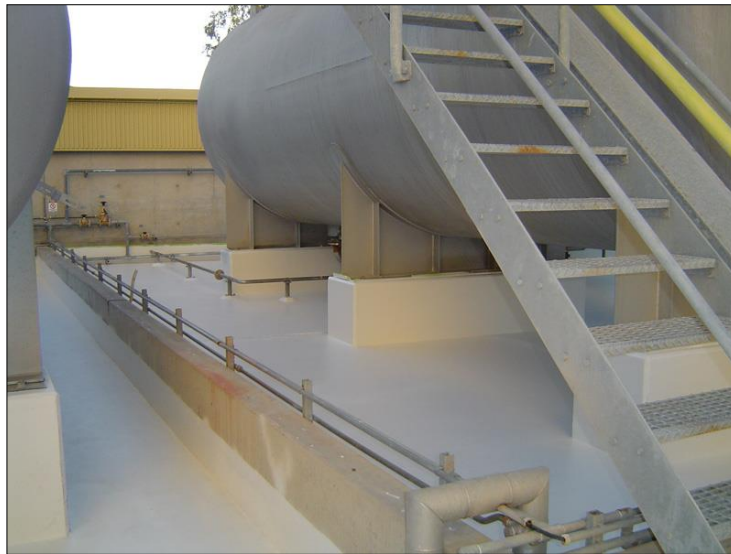
Figura II.154 - Exemplo de um tanque de betão para armazenamento de diesel.
