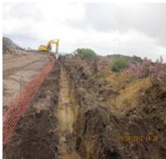
Valas para cabos
