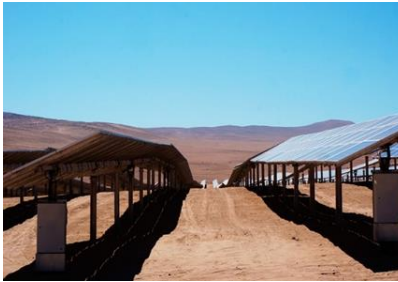
Exemplo de uma Central Fotovoltaica com módulos que acompanham o relevo
