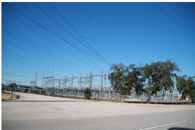
Fotografia 5.13 – Subestação da Falagueira.
