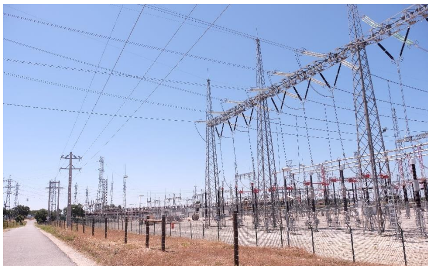
Fotografia 5.18 – Subestação da Falagueira (fonte: Future Proman 2021)
