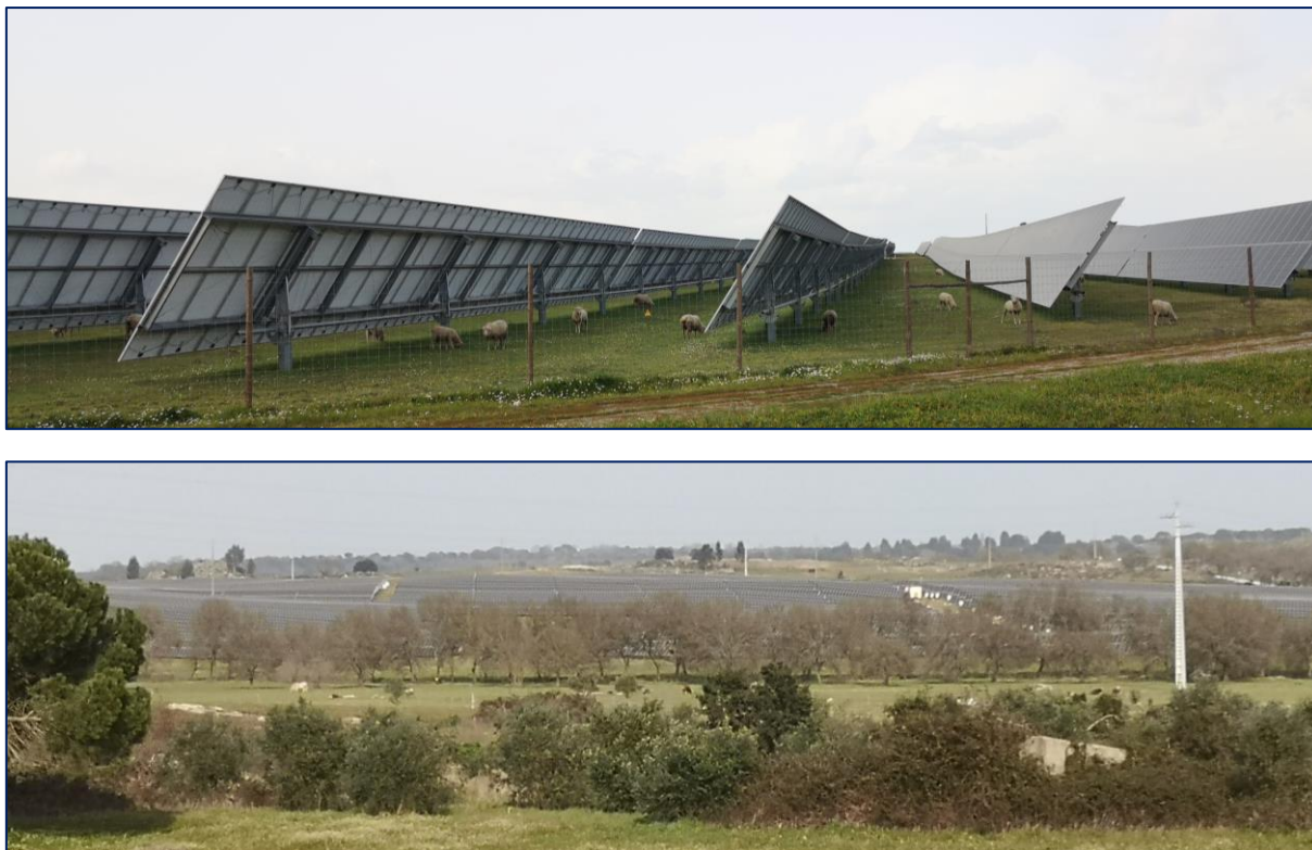
Foto 9.12 – Central Fotovoltaica de Alpalhão.
