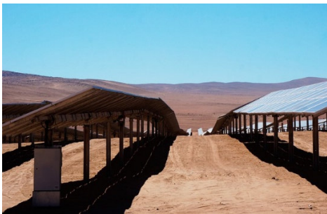
Exemplo de uma Central Solar Fotovoltaica com módulos que acompanham o relevo
