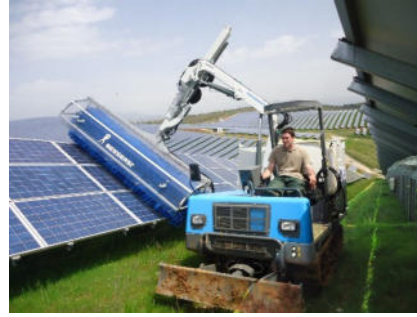
Limpeza dos painéis fotovoltaicos na fase de exploração
