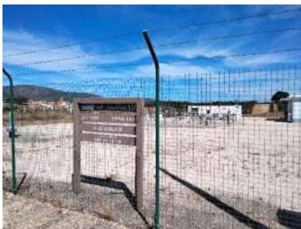
Fotografia 6.19 – Estação de Regulação de Pressão e Medição da Abridada (GRMS 1319)
