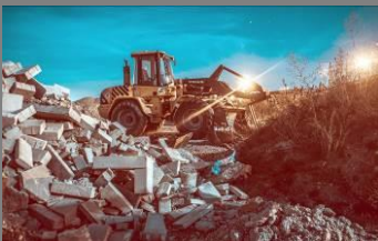
Resíduos de obras
