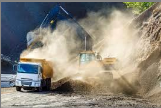
Pó gerado pelas atividades de construção
