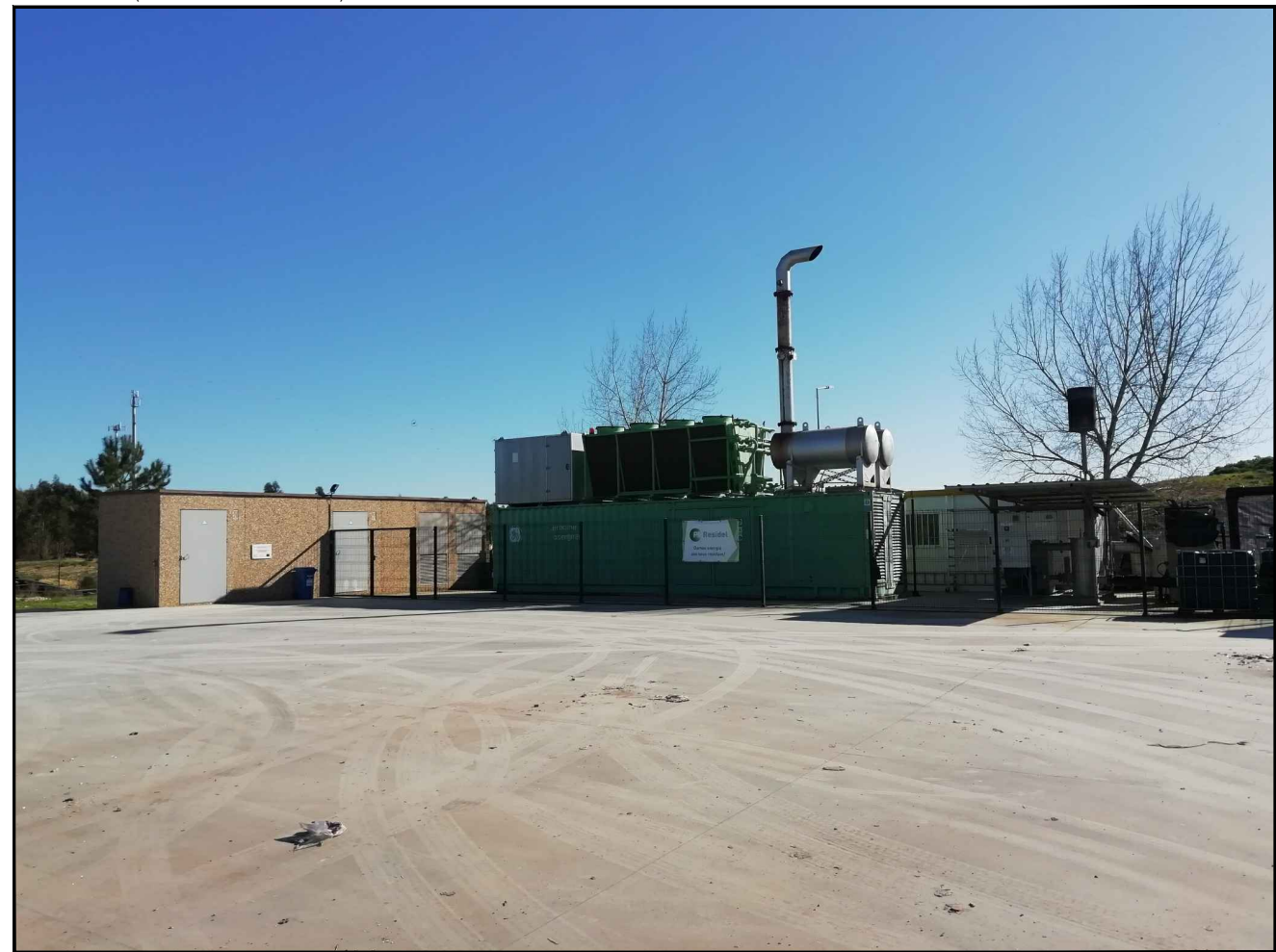
FOTO DA CVE (GRUPO MOTOGERADOR)
