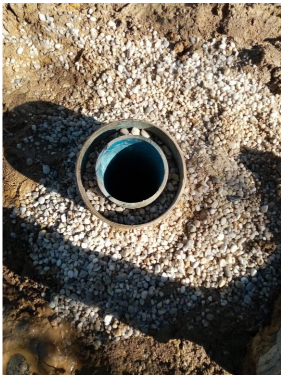
Figura 4. Tubagens em ferro e em PVC utilizadas.
