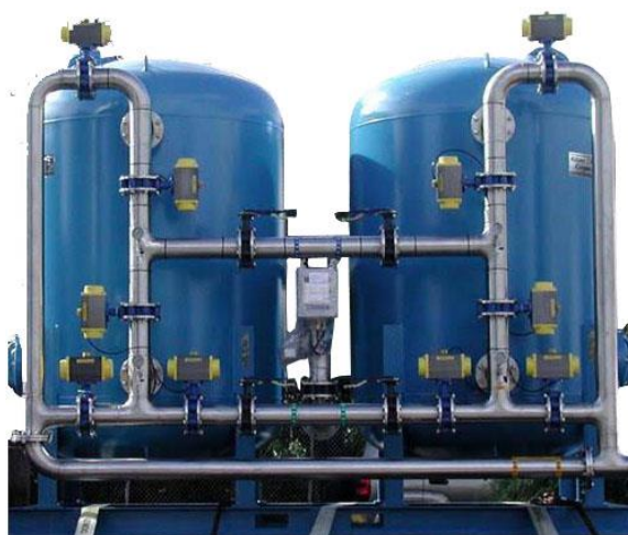
Figura 11 – Filtros de desnitrificação.
