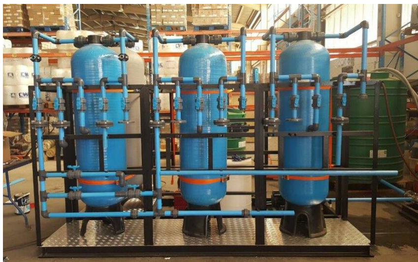
Figura 7 - Skid de permuta iónica
