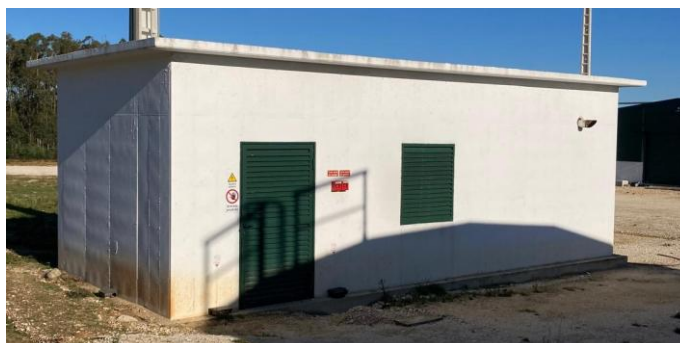
Figura 3.1.6. Exemplo de um edifício do quadro geral e do gerador de emergência.
