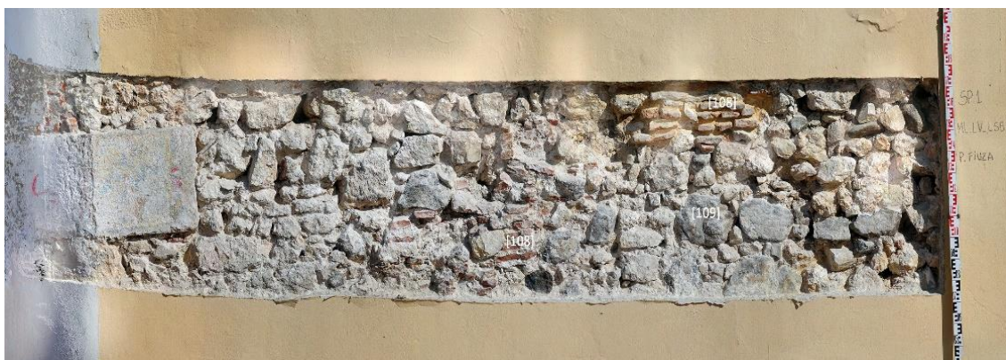
Figura 42 – Plano final da SP1 onde se observa o aparelho construtivo da fachada.
