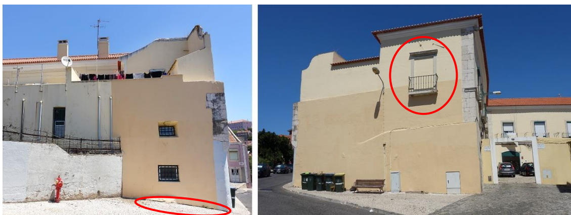
Figura 34 e 35 – Fachada poente junto da qual foi realizada a sondagem e fachada nascente onde se mantem a janela entaipada e varandim que se observava antes das obras dos anos sessenta.
