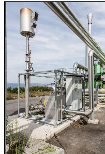
Figura 29 – Queimador de emergência
