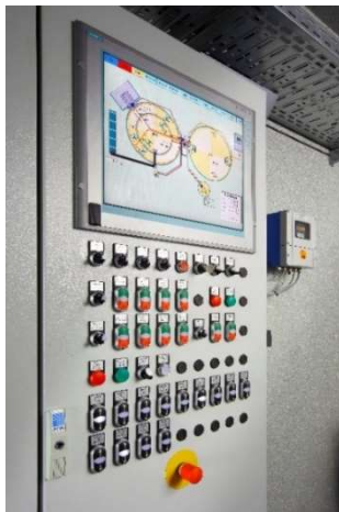
Figura 23 – Armário de Controlo do Sistema
