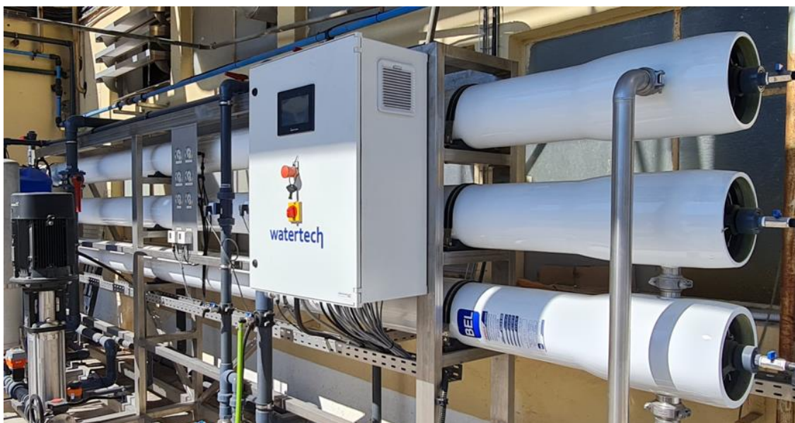
Figura 71- Registo fotográfico de uma unidade de osmose inversa
