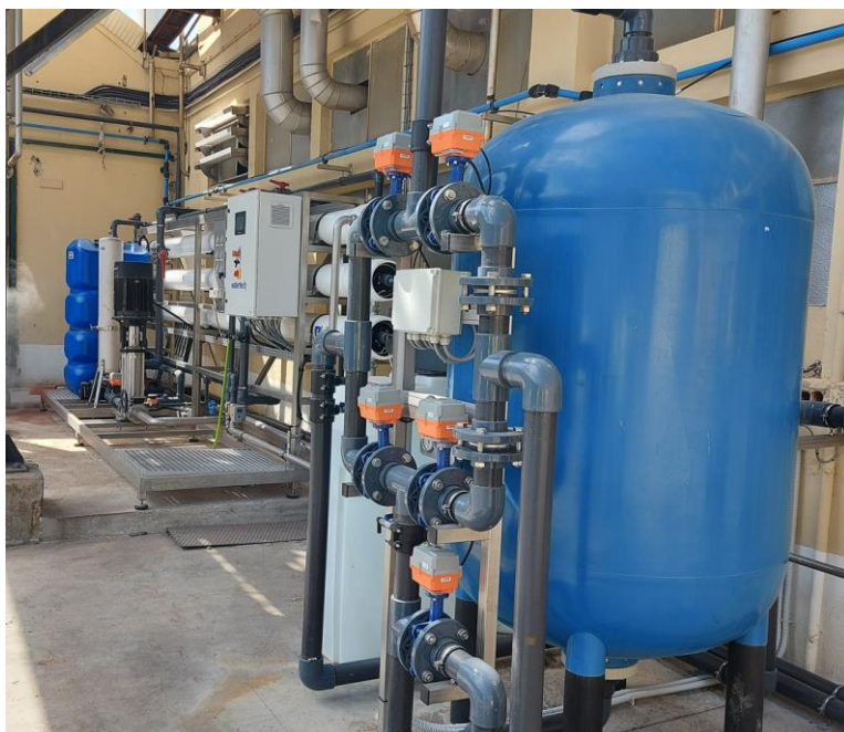
Figura 65 – Registo fotográfico do sistema a instalar de tratamento de água por osmose inversa
