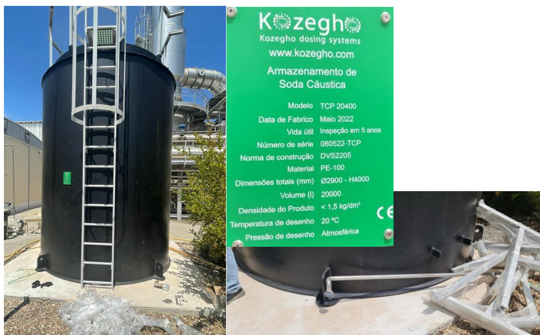
Figura 60- Registo fotográfico do depósito de dupla parede de armazenagem solução alcalina
