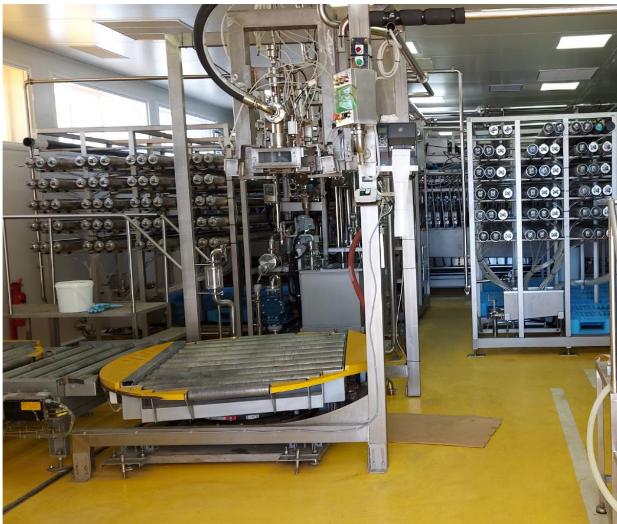
Figura 51- Registo fotográfico da nova linha de Osmose Reversa.
