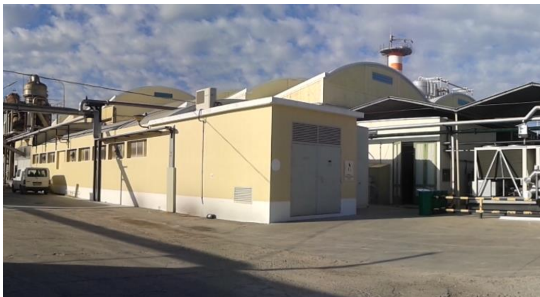
Figura 58 – Registro fotográfico do edifício antes da instalação dos chillers.
