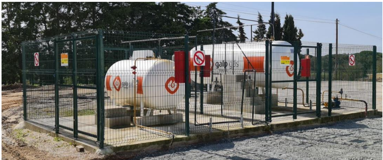
Figura 18- Registo fotográfico dos novos depósitos de GPL (à esquerda o depósito mais pequeno e à direita o de maiores dimensões).
