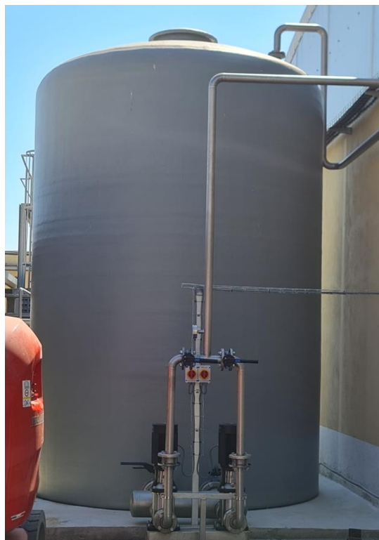
Figura 78 – Registo fotográfico de depósito de armazenagem de água tratada por osmose inversa
