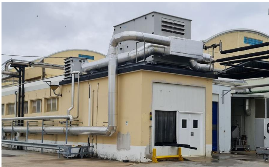
Figura 59 - Registro fotográfico do edifício após a instalação dos chillers.
