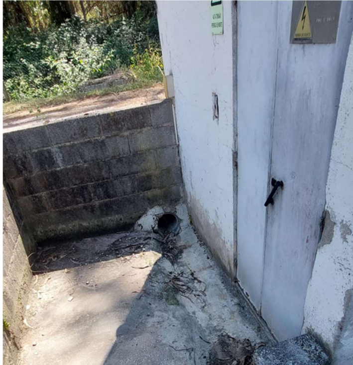
Foto 7 – Grelha de escoamento junto à porta de entrada do PT
