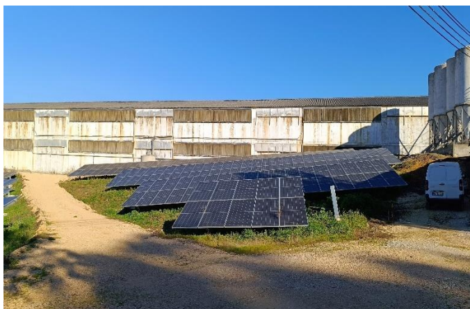
Figura 0.1 – Vista para os painéis fotovoltaicos
