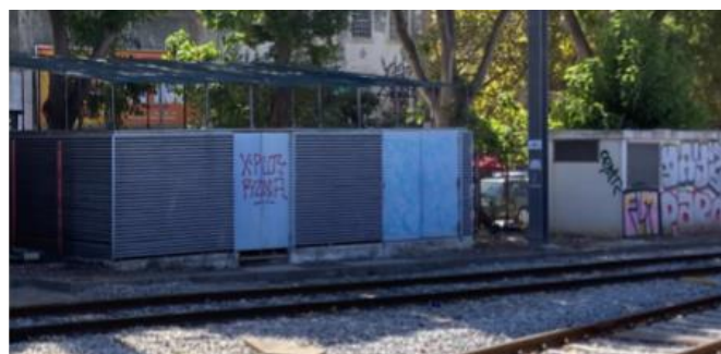
Figura 4 – Espaços técnicos junto à via na atual Estação de Alcântara Terra
