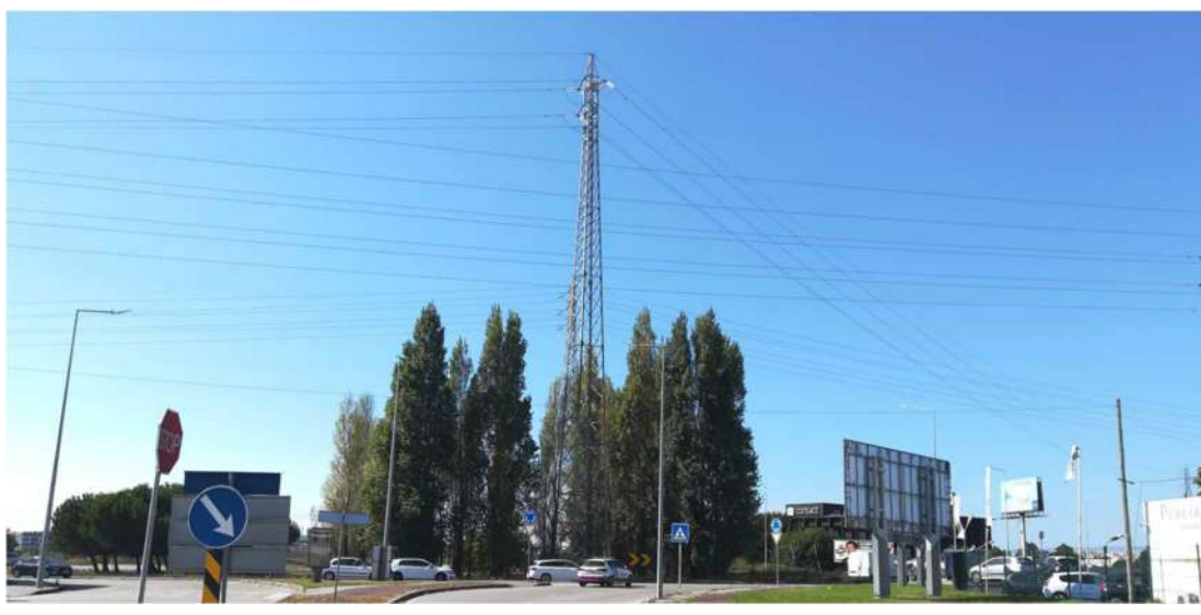
Figura 6.14 – Rede de alta tensão no acesso a Aveiro
