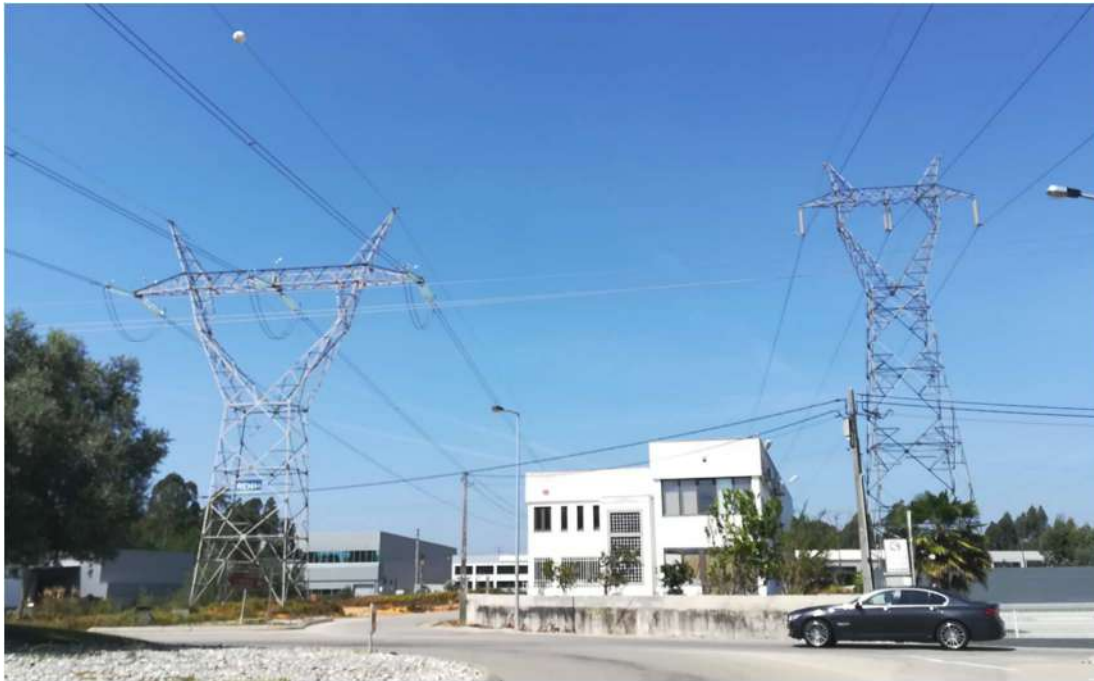
Figura 6.9 – Rede de alta tensão - vista para este no acesso a Águeda
