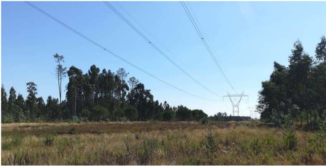
Figura 6.10 – Rede de alta tensão - na proximidade do ERSUC - Aveiro
