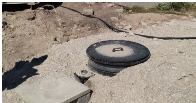
Figura 17: Separador de hidrocarbonetos instalado.
