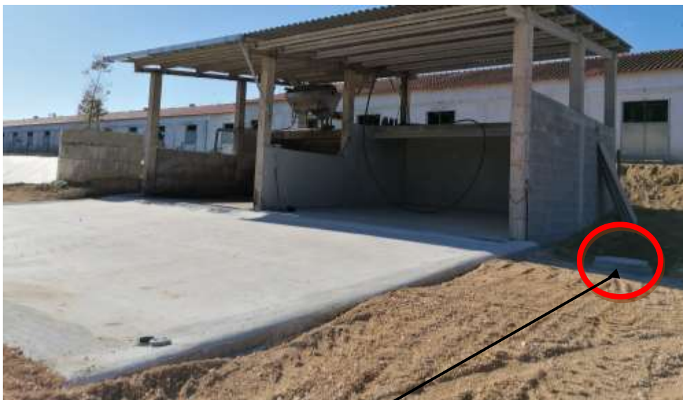
Fossa para recolha de Escorrências provenientes de nitreira
