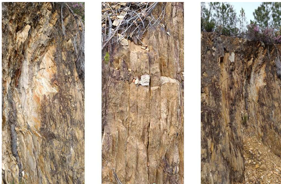
Figura 2.18 – Aspeto dos filitos existentes num talude da estrada asfaltada CM1238.
