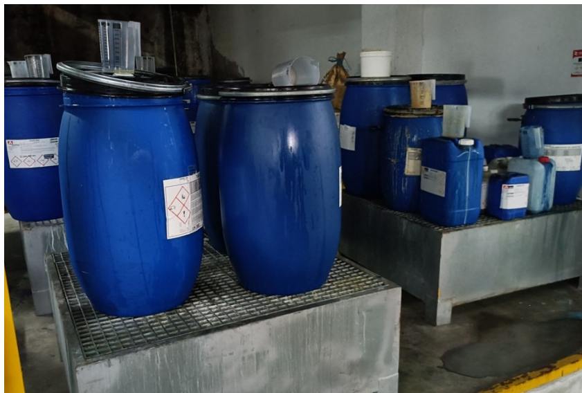
Figura 1 – Bacias de retenção dos produtos químicos no estabelecimento da Riler
