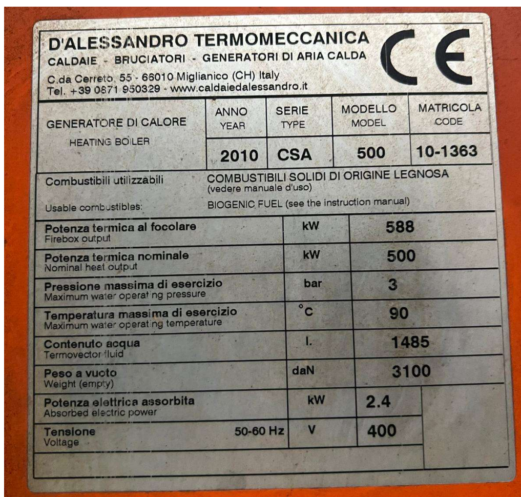
Foto 1: Placa identificativa da caldeira instalada no pavilhão existente
