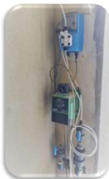
Figura 2. 4-Sistema de desinfecção da água captada
