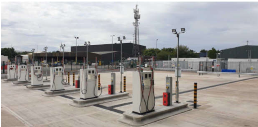
Figura 10. Exemplo de conjunto de estações de enchimento de trailers de BioGNC
