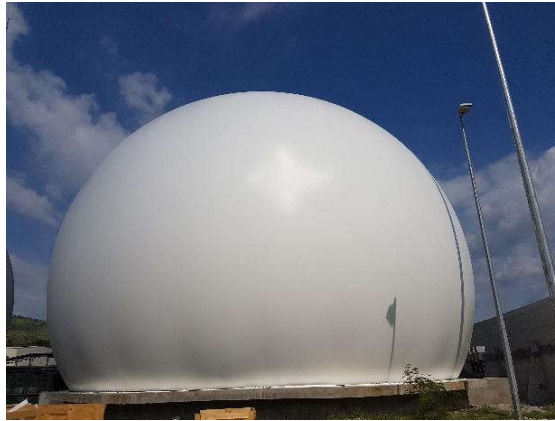
Figura 4 - Exemplo de um gasómetro de chão
