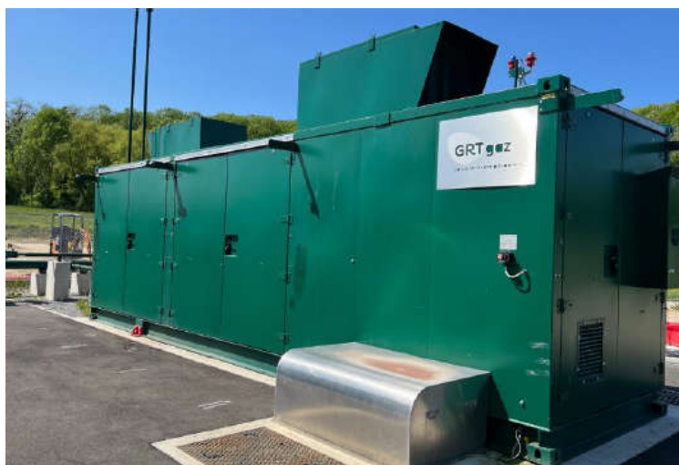
Figura 9. Exemplo de compressor operado pelo operador da rede de transporte de gás francesa
