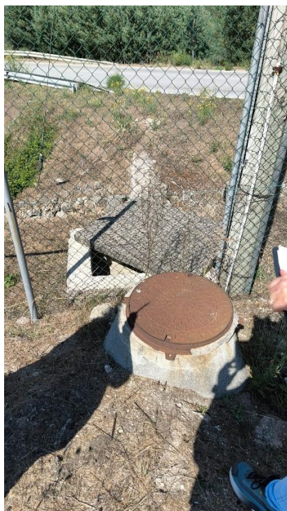
Figura 9 – Ponto de Entrega das águas pluviais e coletor público da rede de águas pluviais.
