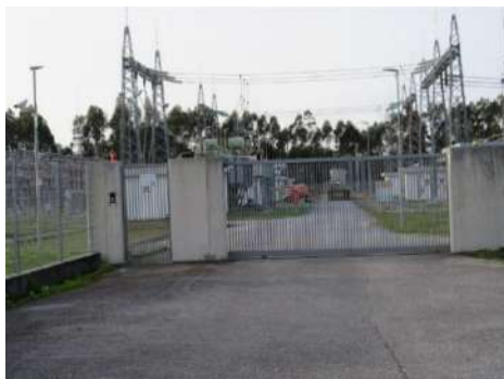
Subestação de Vila Fria – REN (ponto de entrega).
