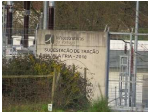
Subestação de Tração de Vila Fria – IP.
