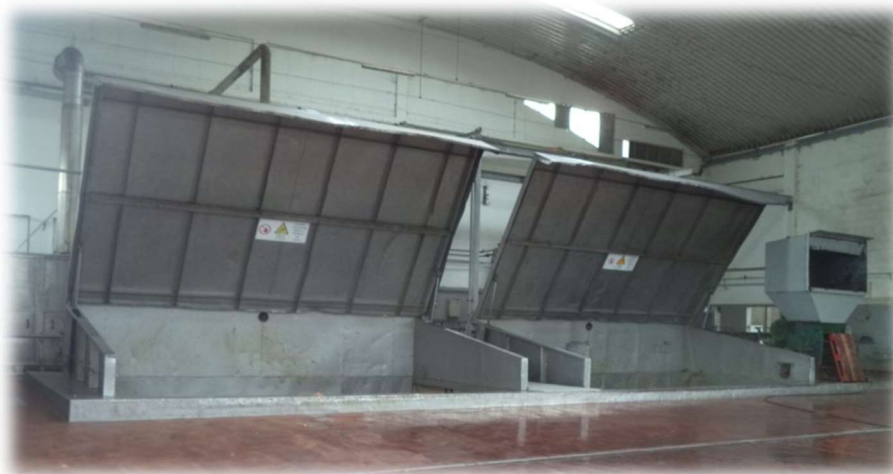
Figura 11 – Registo fotográfico da tolva de receção de SPOA's a granel
