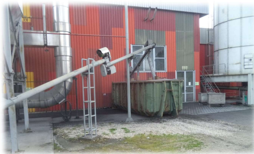
Figura 10 – Local de armazenamento das cinzas provenientes da queima de biomassa
