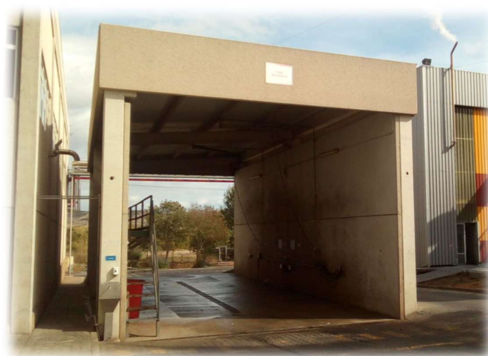
Figura 2 – Fotografia do túnel de lavagem de viaturas de transporte de SPOA's
