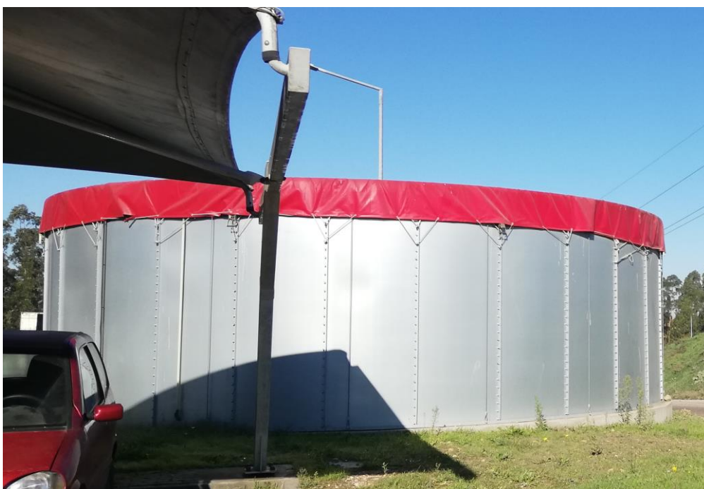
Figura 2 – Reservatório de reserva de incêndio
