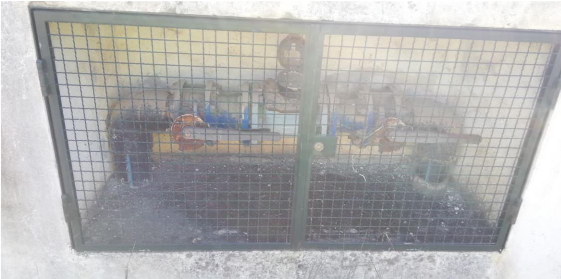
Figura 1 – Contador de água potável dos SMAS de Leiria
