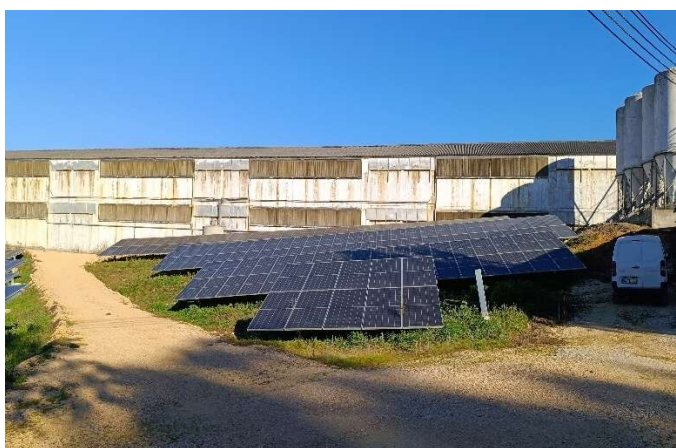
Figura 6.1 – Vista para os painéis fotovoltaicos
