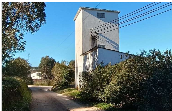
Figura 6.3 – Vista para o Posto de Transformação
