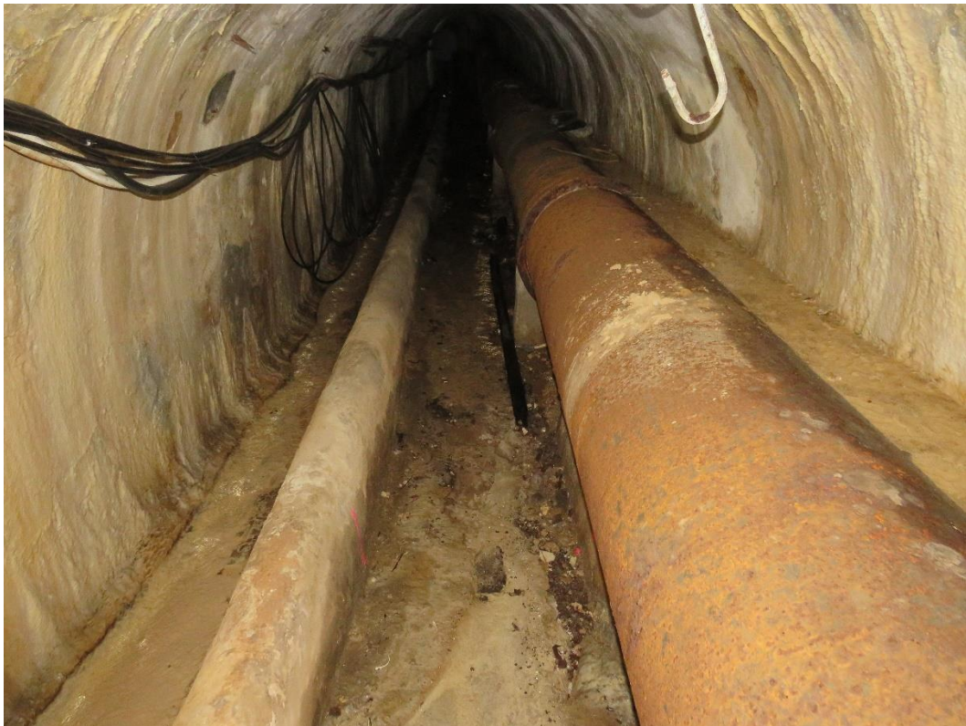
Foto 2 – Vista do interior do aqueduto na zona sobre o Eixo do túnel
