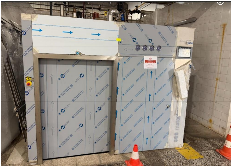
Figura 1 – Local de instalação/substituição de autoclave da matachana.
