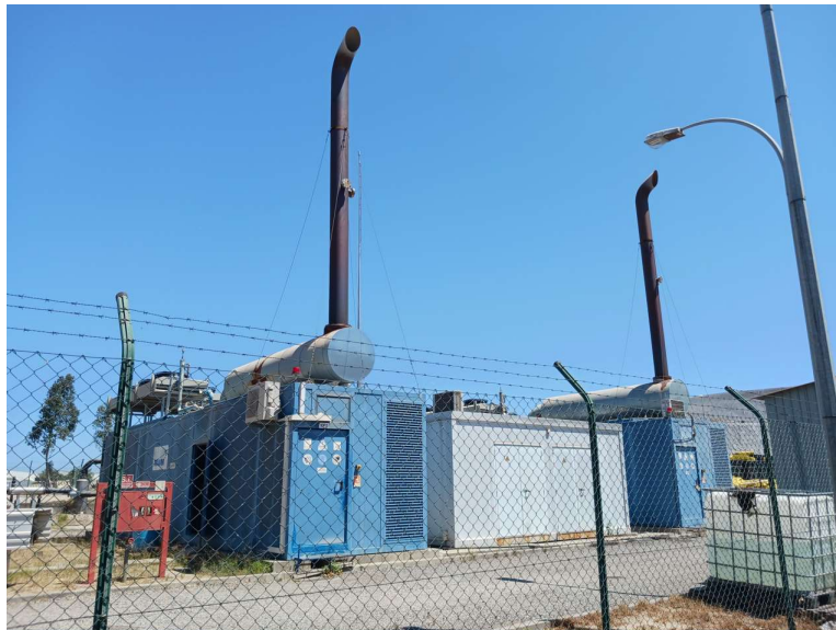
Fonte FF1 (esquerda) e FF2 (direita) – chaminés dos motogeradores de combustão interna
