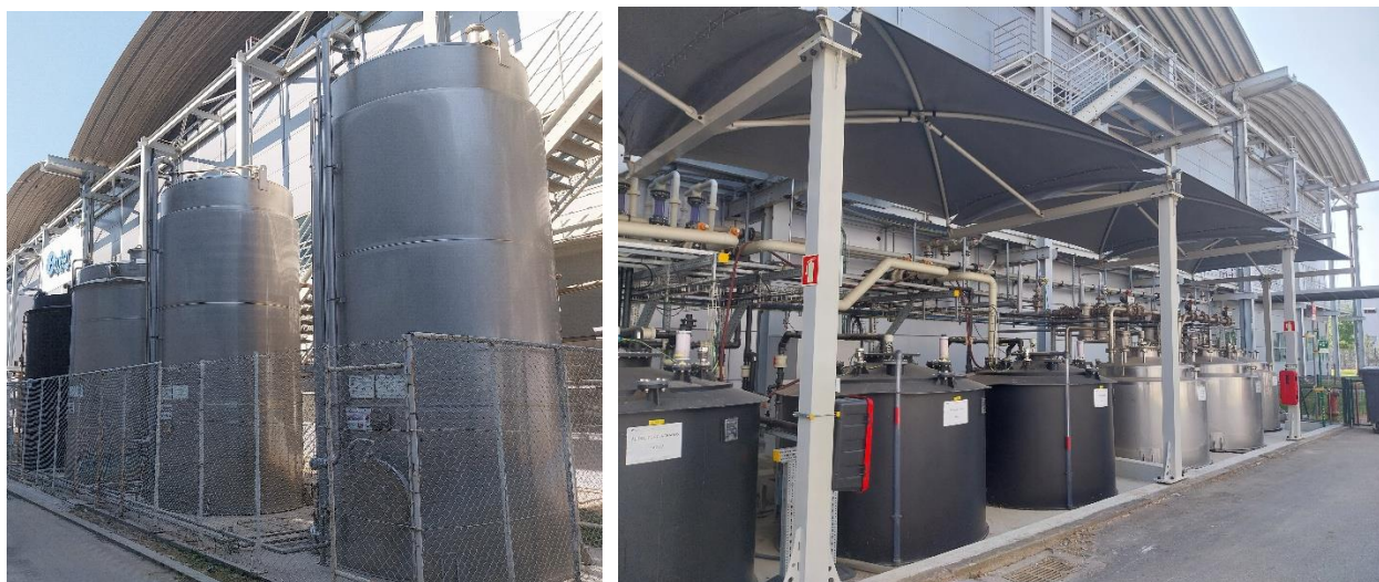
Figura 4. Área de tanques de armazenamento intermédio de resíduos solventes líquidos para envio para OGR e efluente para encaminhamento para a ETAR.
