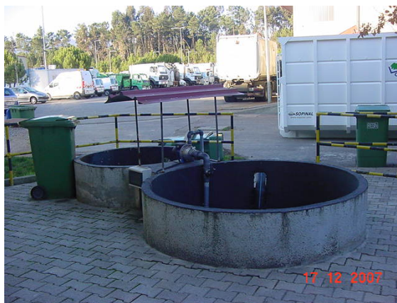
Figura 1 – Tanques receção de águas residuais
