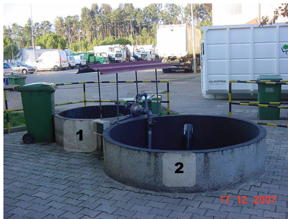
Figura 4 – Identificação dos tanques
