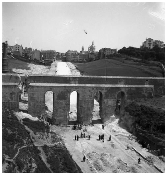
Figura 136 – Aqueduto demolido para a abertura da Avenida Infante Santo. Início dos trabalhos de demolição do troço do Aqueduto para a abertura da avenida Infante Santo , fotografia de Judah Benoliel, 1949, PT/AMLSB/CMLSBAH/PCSP/004/JBN/004154.
