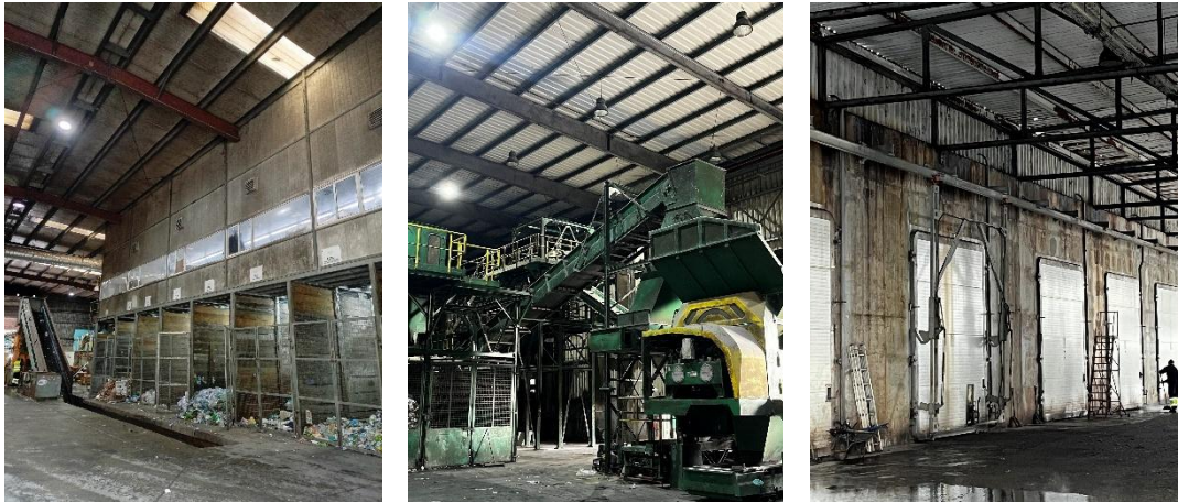
Figura 87 – Instalações de triagem (esquerda), tratamento mecânico (centro) e valorização orgânica (direita).
