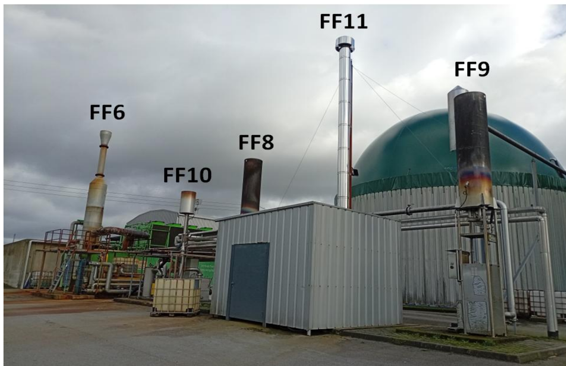
Figura 85 – Fotografia das fontes fixas FF6, FF8, FF9, FF10 e FF11.
