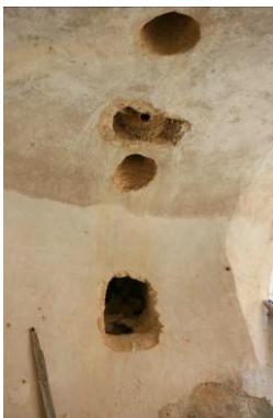
07 – Oc. 1, Piso térreo, perfurações de mecanismo na cobertura
