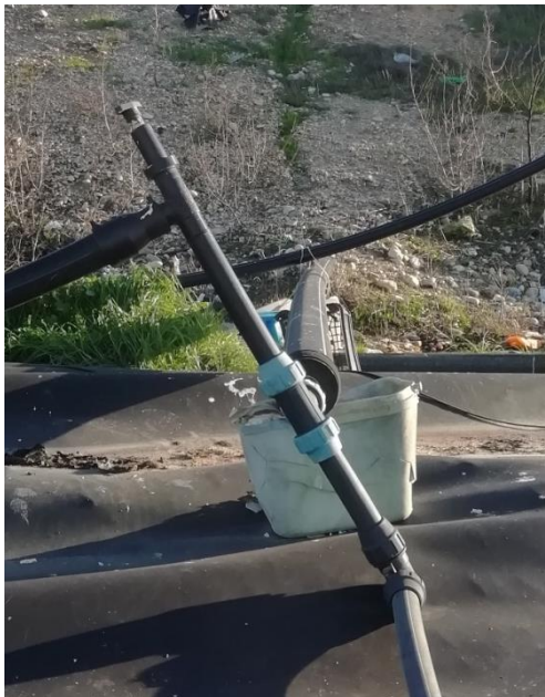
Poço de biogás horizontal
