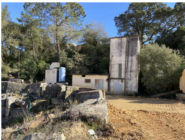
Foto 11 – PT: unidade de fornecimento de energia à pedreira.
