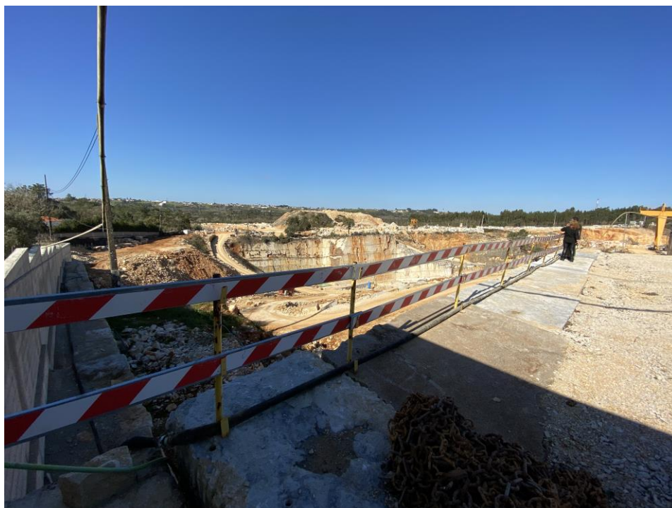
Foto 4 – Vedação de segurança junto ao setor SE da cava, a qual é extensível a outros setores com perigo de queda em altura.
