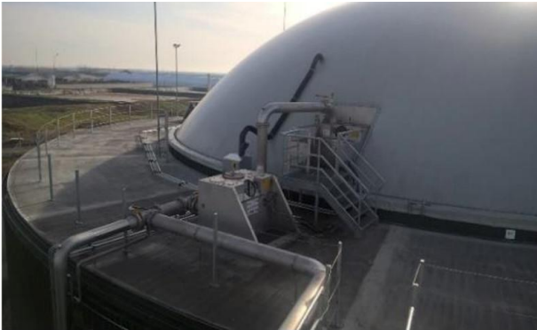
Figura 5 - Aspeto de digester Triton previsto para o projeto
