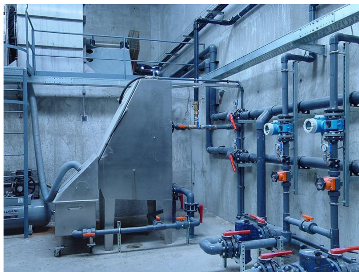
Figura 10 - Filtro rotativo e tubagem de água.
