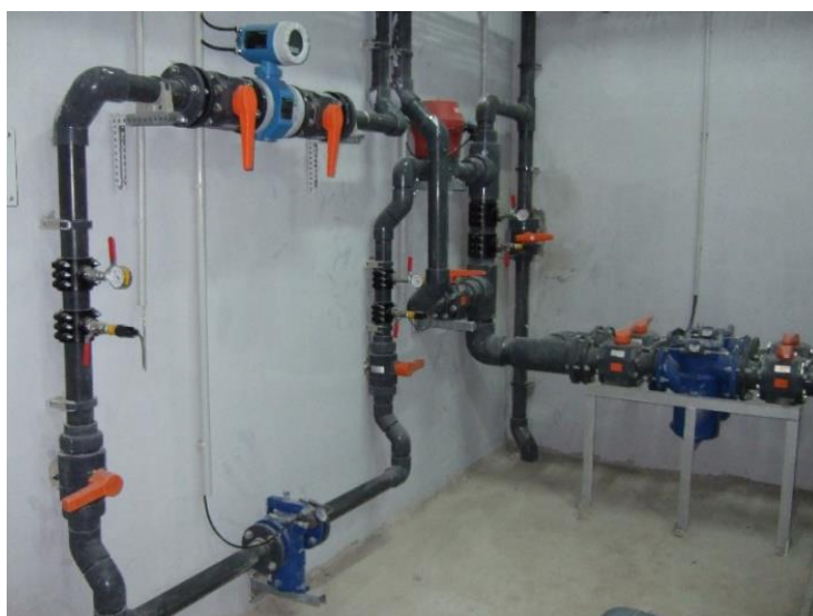
Figura 4 Sistema de irrigação com filtro e caudalímetro
