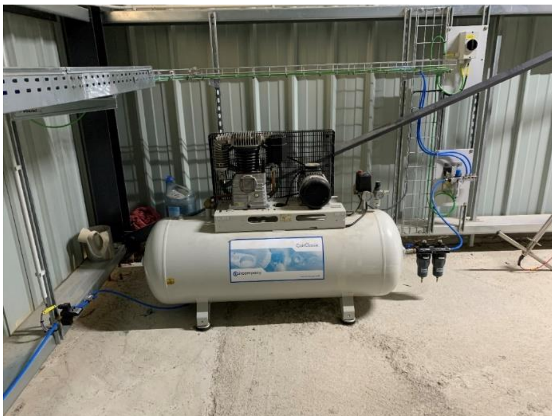
Figura 15 -Exemplo compressor de ar
