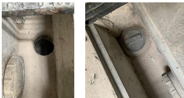
Figura 3 Caixas de visita para manutenção e limpeza.
