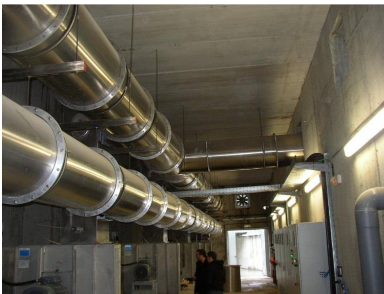
Figura 9a - Unidade de ventilação do túnel.
