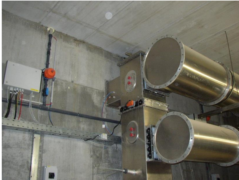
Figura 9b - Unidade de ventilação do túnel.
