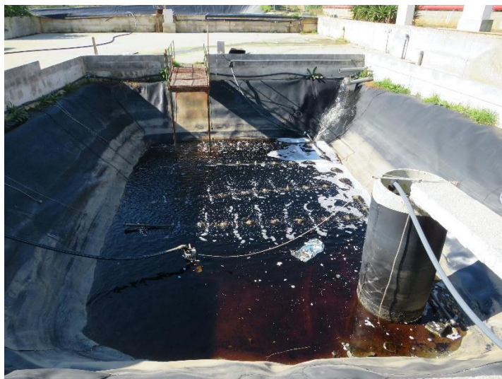
Fotografia 3-11 – Tanque de arejamento e regularização do permeado resultante da Osmose Inversa.
