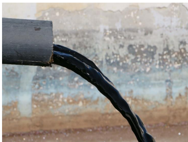
Fotografia 3-8 – Concentrado efluente do sistema de Osmose Inversa.
