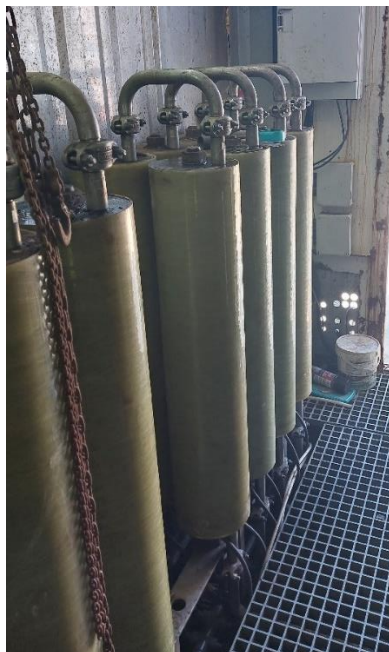
Fotografia 3-7 – Módulos de membranas da Osmose Inversa.
