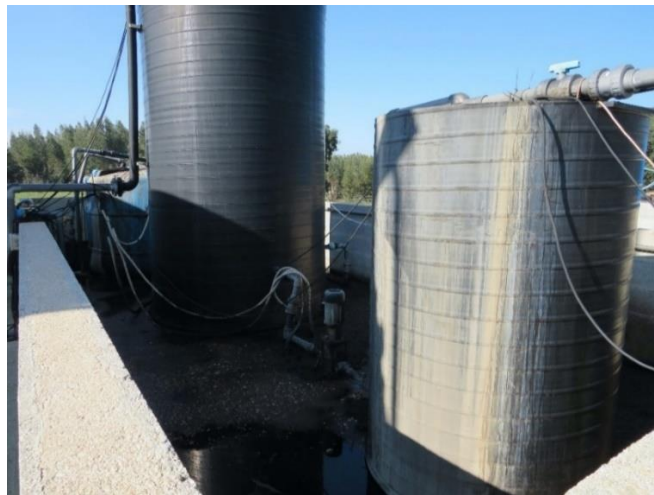
Fotografia 3-6 – Tanque de equalização interno da Osmose Inversa.
