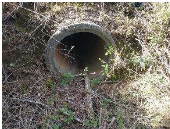
FOTO 8 – SAÍDA DE PH SEM MUROS ALA E SEM MURO TESTA
