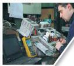
Cableado de cuadro eléctrico Control panel wiring
