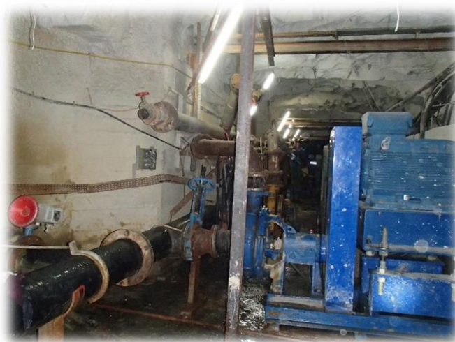
Figura 5 - Estação de bombagem, no interior da mina.
