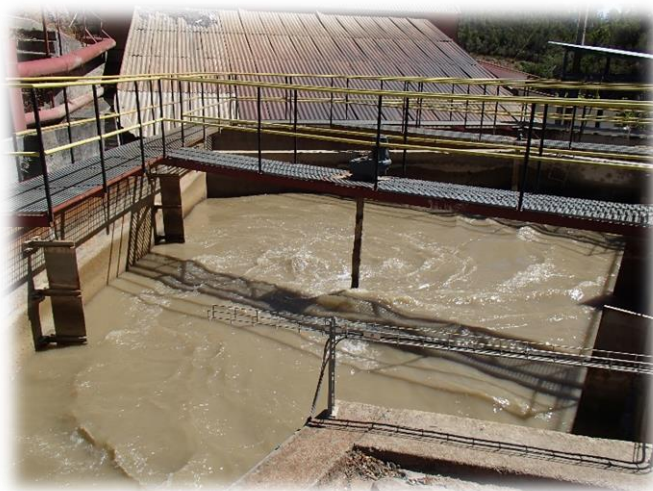
Figura 7 - Tanque de recepção.
