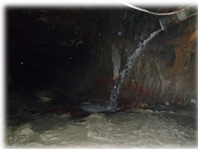
Figura 4 - Tanque de armazenamento de águas residuais da instalação de bombagem, no interior da mina.
